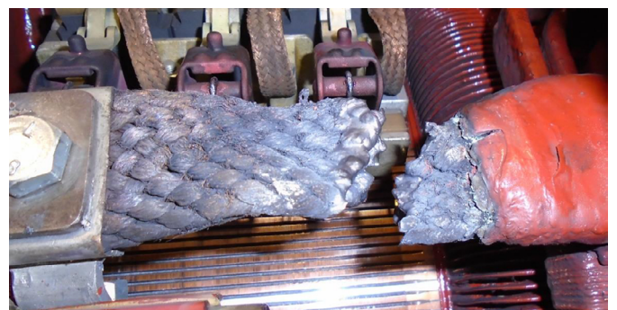
Der durchgeschmolzene Bürstenbrückanschluss
